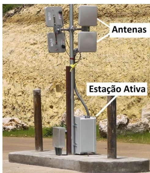
Figura 10 – Estação ativa com suas antenas
